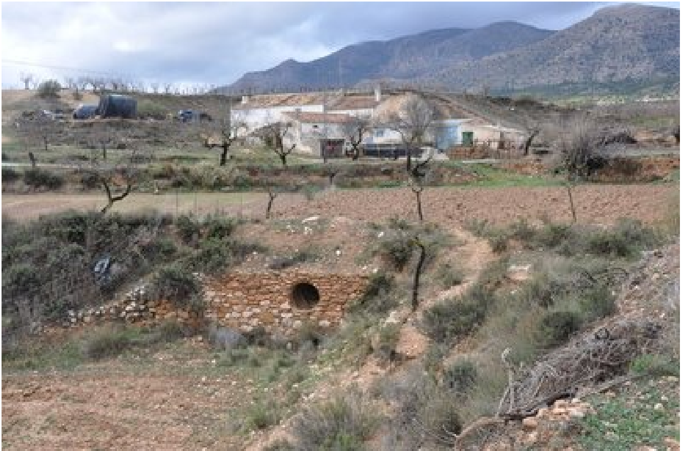
Galería de drenaje en una cañada velezana.
